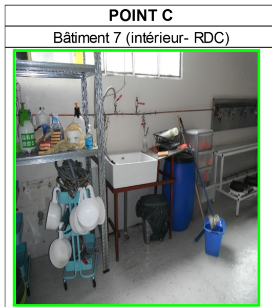
Figure 5 : Point de prélèvement du réseau rénovée d'eau du robinet
