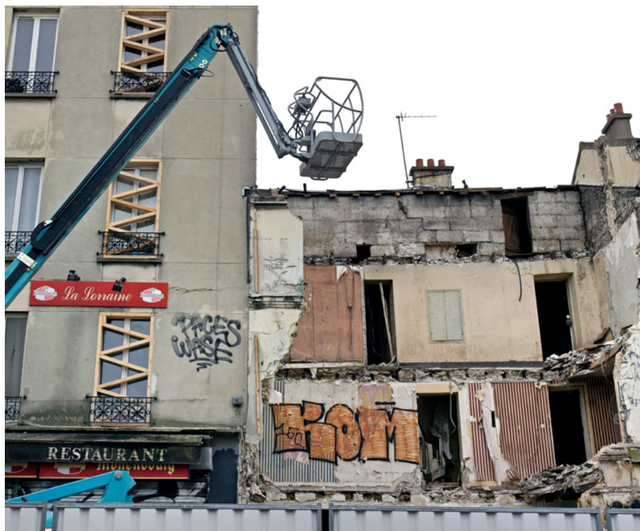
Les restes de l'immeuble effondré sont dégagés et les abords sécurisés.
