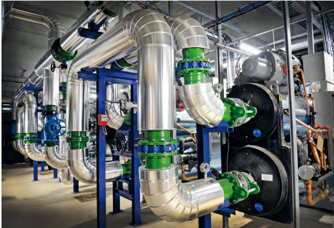
Voici les tuyaux de l'usine de géothermie qui chauffe déjà la ZAC Boissière – Acacia.
