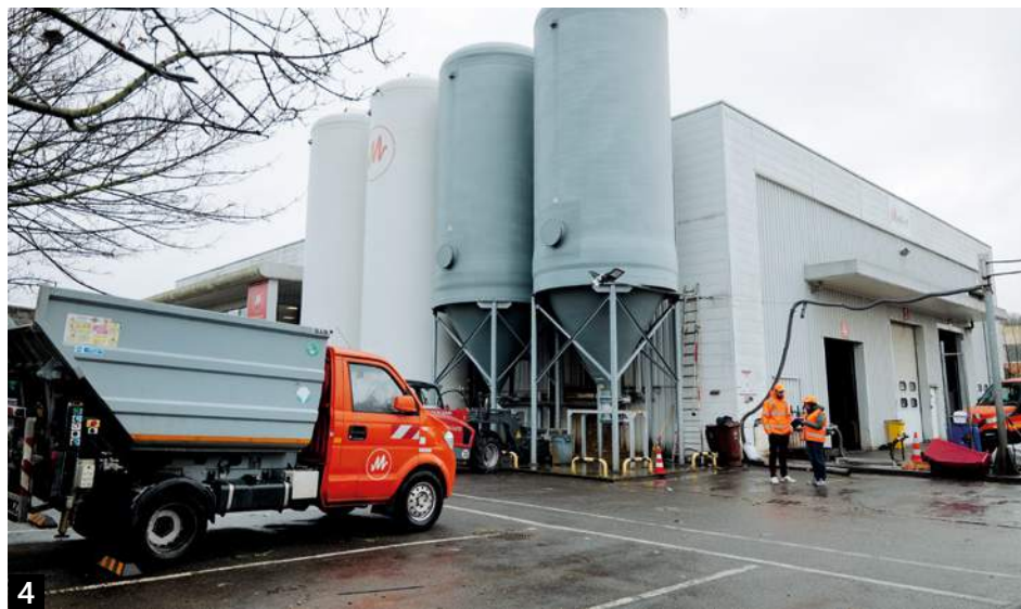
4 La « soupe » est stockée dans ces cuves avant d'être emportée en camion-citerne vers les méthaniseurs de Seine-et-Marne.
